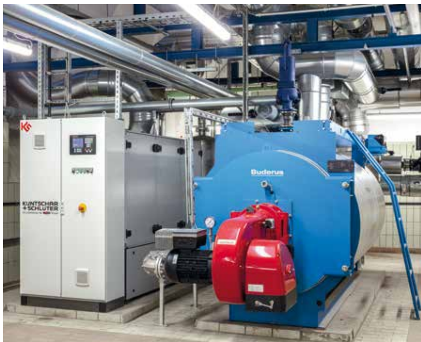
Schlossareal in Bruchsal: Das Blockheizkraftwerk (links) und der Gaskessel (rechts) wurden über ein Energiespar-Contracting finanziert.
