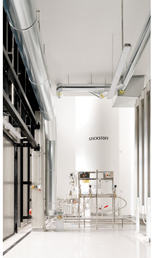
Die Hochpräzisionsmessräume bilden das Kernstück des Forschungsgebäudes.
