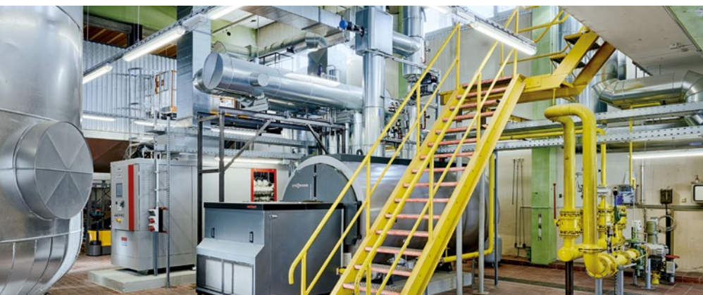
Grüne Energie für die Hochschule für Polizei Baden-Württemberg in Lahr: sanierte Energiezentrale, dezentralisierte Warmwasserbereitung und optimierte Wärmeversorgung, abgerundet durch eine Photovoltaikanlage, die durchschnittlich 67.000 Kilowattstunden pro Jahr erzeugt.
