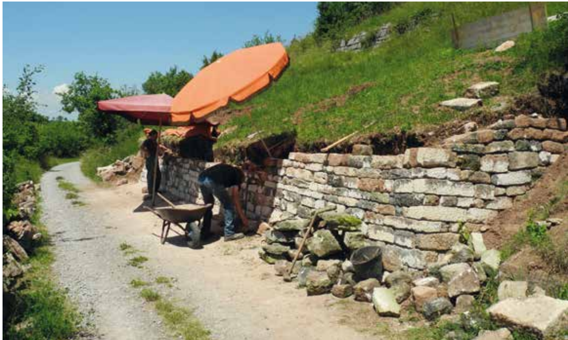
Die Weinbergmauern im Bereich Morgenstelle in Tübingen werden per Hand neu aufgesetzt.
