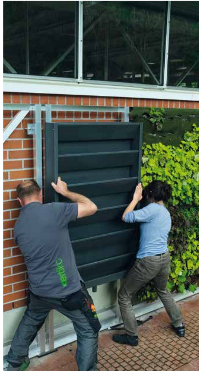
Montage von Testflächen als fassadengebundene Begrünung mit Bewässerung durch Grauwasser an der Hochschule für Wirtschaft und Umwelt in Nürtingen.
